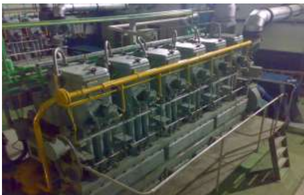
Рис. 1. Опытно-промышленная установка на Павловском автобусном заводе
