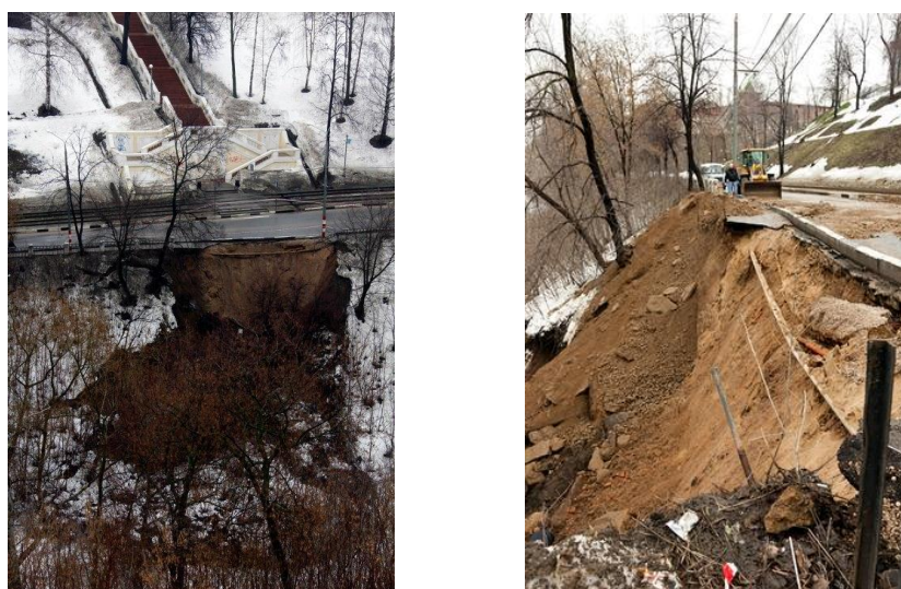
Рис. 7. Оползень 12 апреля 2012 года в Почаинском овраге в Нижнем Новгороде 12 апреля 2012 года (слева), (справа)
