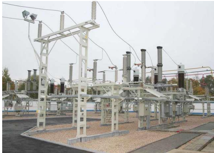
Рис. 2. Источники ЭМП на ПС
