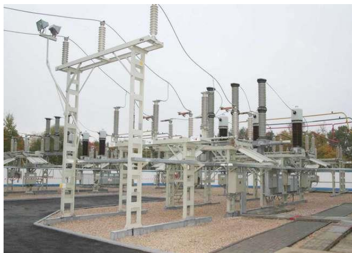
Рис. 2. Источники ЭМП на ПС
