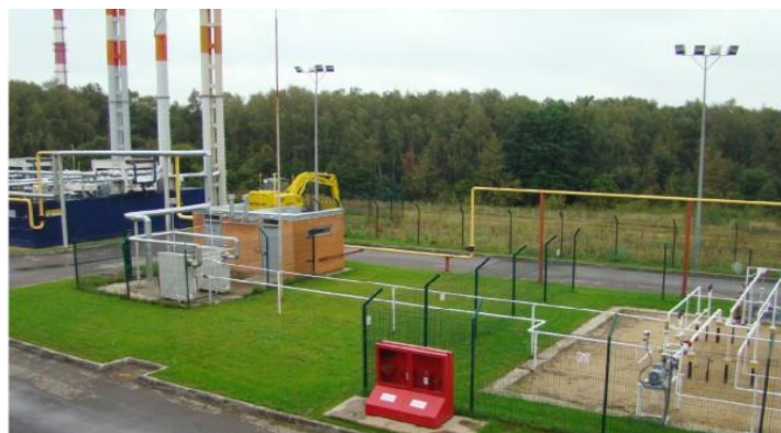
Рис. 1. Мини-ТЭЦ с газопоршневыми двигателями
