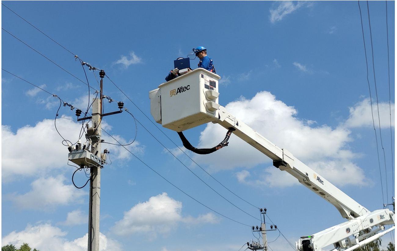
Рисунок 115 – Процесс мониторинга ВЛ 10 кВ бесконтактным способом в непосредственной близости от токоведущего провода ВЛ
