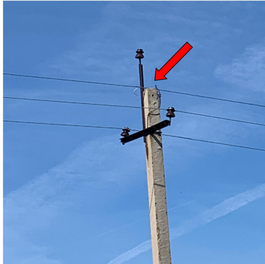
Рисунок 79 – Иллюстрация обрыва вязки провода на керамическом изоляторе ВЛ 10 кВ
