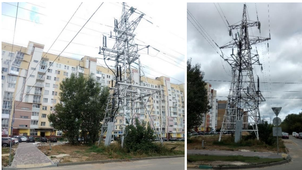
Рисунок 1.1 – Переходный пункт ВЛ-КЛ на опоре №15 КВЛ 110 кВ «Канавинская»
