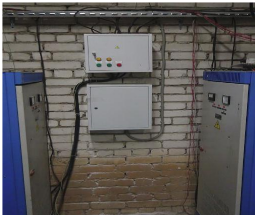
Рис. 6. Фотография шкафов управления стендом
