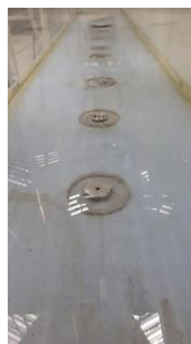
Рис. 3. Датчики, установленные в дне бассейна
