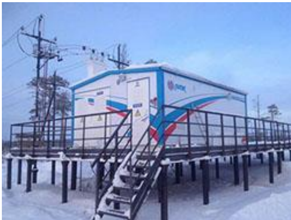
Рис. 1. Комплектная трансформаторная подстанция в утепленной оболочке из сэндвич-панелей
