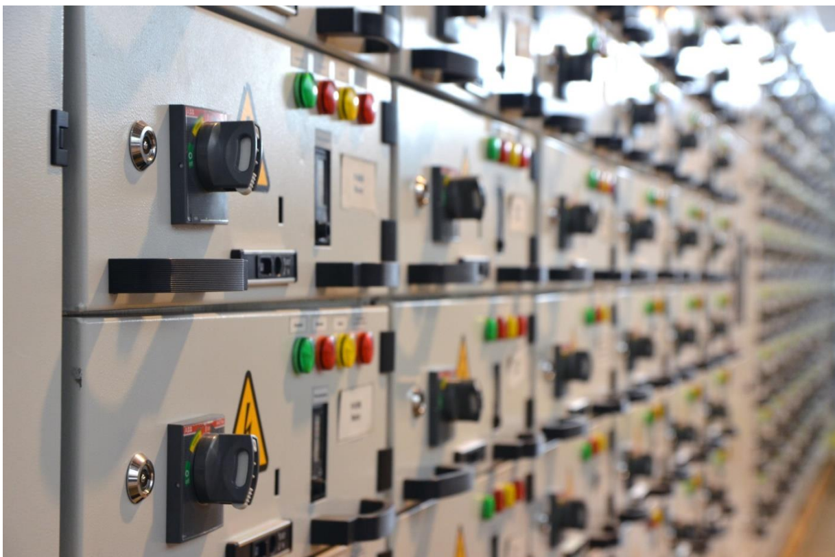
Рис. 1. Современное электротехническое оборудование НКУ «Каскад» для КТП
