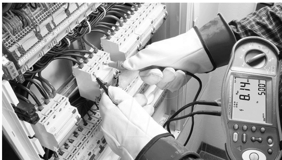
Рис.4 Измерение сопротивления изоляции цифровым мегомметром
