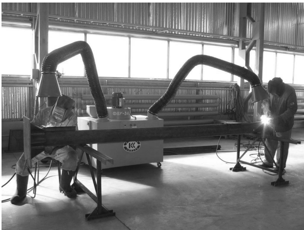
Рис. 5.2. Местная вентиляция необходима над каждым рабочим местом сварщика
