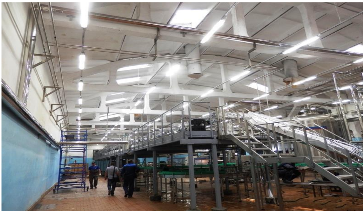
Рис. 6.4. Общее освещение цеха
