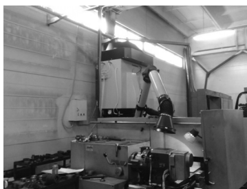
Рис. 5.2. Установка для улавливания аэрозолей
