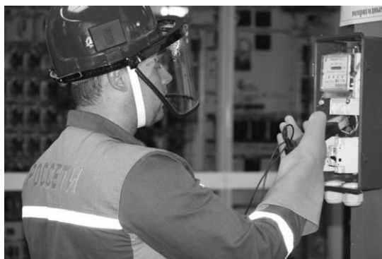
Рис. 4.1. Проверка отсутствия напряжения
