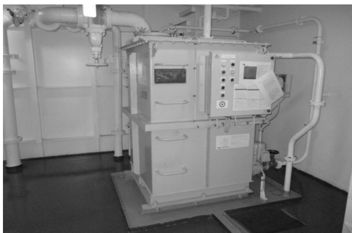
Рис. 5.3. Биоустановка для очистки сточных канализационных вод
