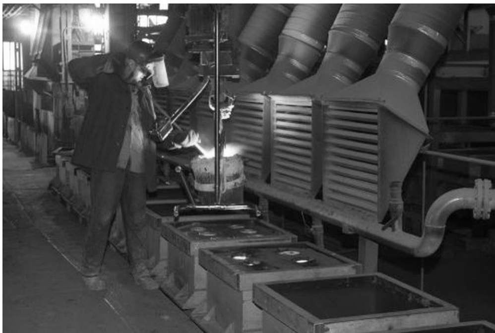
Рис. 5.6. Вытяжная вентиляция заливочного конвейера
