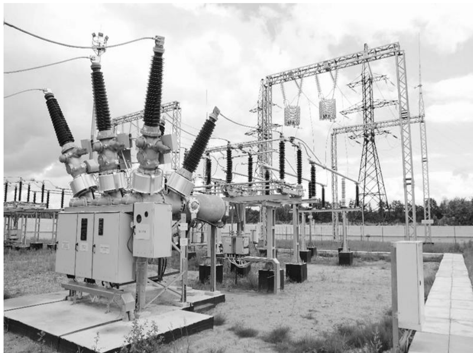
Рис. 6.2. Рабочее место – высоковольтная подстанция 220 кВ
