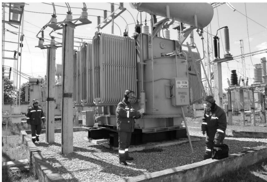
Рис. 6.1. Рабочее место – высоковольтная подстанция 330 кВ
