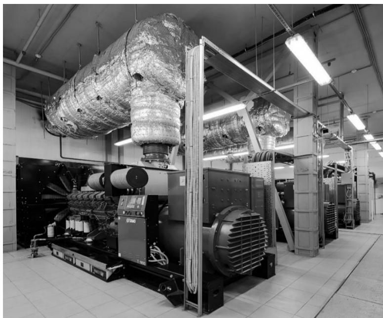
Рис. 5.1. Рабочее место – дизельная электростанция
