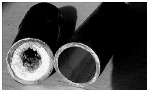
Рис. 63. Водогрейные трубки котлов до и после очистки от накипи
