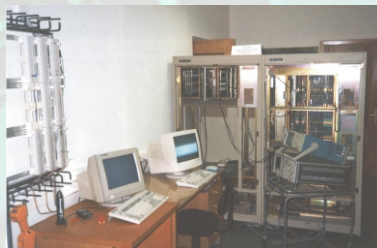
Здесь осуществляется коммутация информационных потоков ИГТУ
